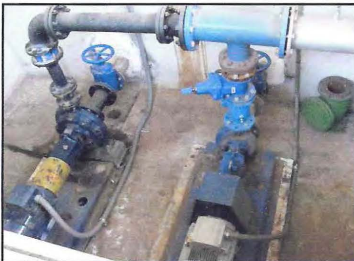
Figura 6.8- Equipos de bombeo PEAP recinto estanques Santa Lucia Fuente: Proyecto, Diseño mejoramiento sistema de producción de agua potable de Collipulli, elaborado por S&E consultores.
