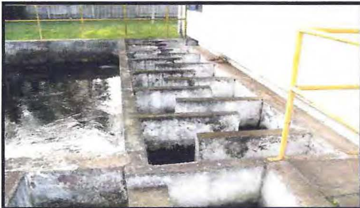
Figura 6.11- Floculador hidráulico existente. Fuente: Proyecto, Diseño mejoramiento sistema de producción de agua potable de Collipulli, elaborado por S&E consultores.
