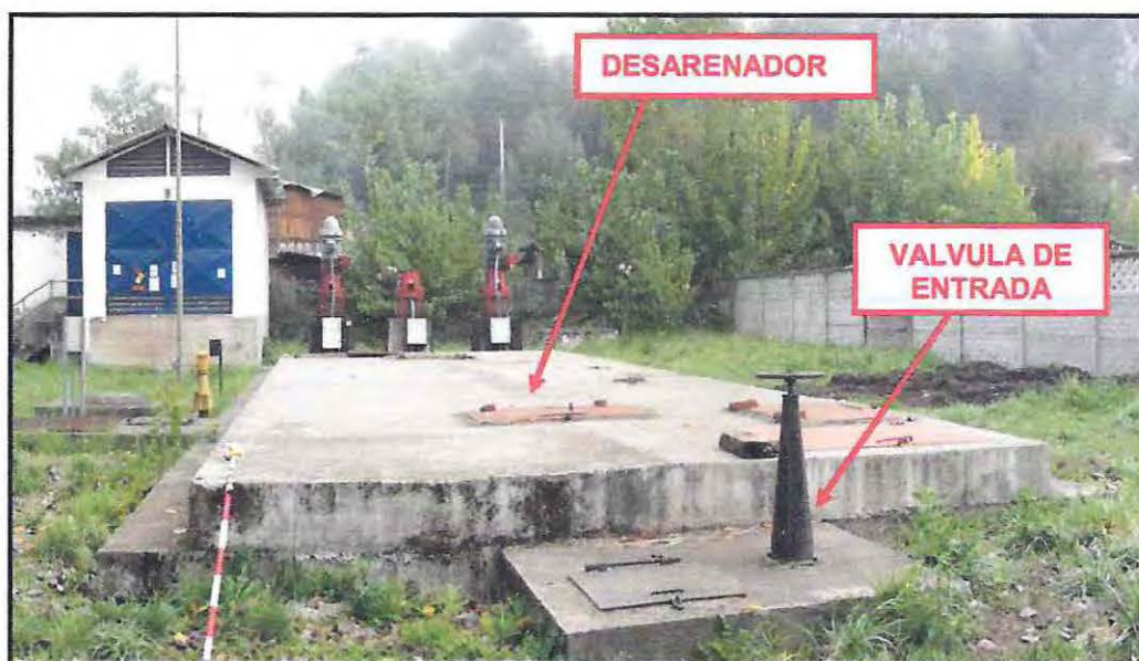
Figura 6.2- Desarenador recinto Río Malleco Fuente: Proyecto, Diseño mejoramiento sistema de producción de agua potable de Collipulli, elaborado por S&E consultores.
