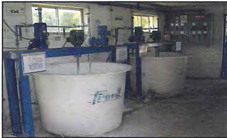
Figura 6.10- Equipos de dosificación de coagulantes. Fuente: Proyecto, Diseño mejoramiento sistema de producción de agua potable de Collipulli, elaborado por S&E consultores.
