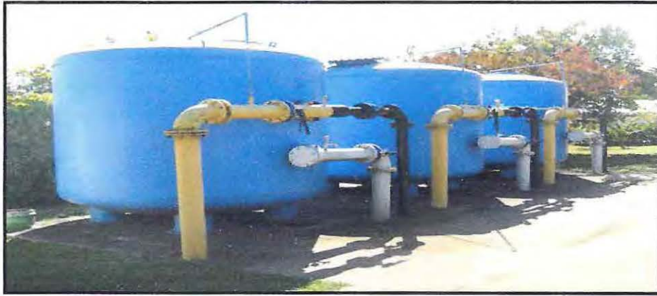
Figura 2.3 - Filtros a presión, PTAP Collipulli. Fuente: Proyecto, Diseño mejoramiento sistema de producción de agua potable de Collipulli, elaborado por S&E consultores.
