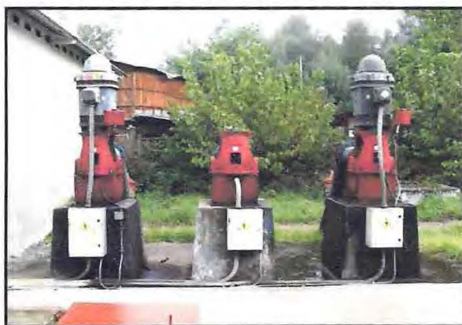
Figura 6.4- Equipos de bombeo PEAP Río Malleco Fuente: Proyecto, Diseño mejoramiento sistema de producción de agua potable de Collipulli, elaborado por S&E consultores.
