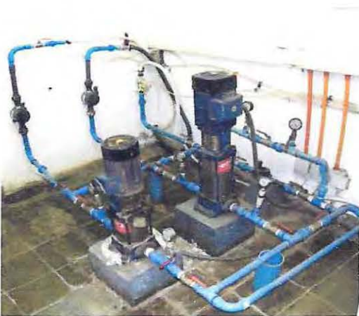
Figura 2.4: Equipos de cloración, PTAP Collipulli.
