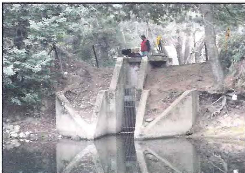
Figura 2.1- Captación Rio Malleco, PTAP Collipulli. Fuente: Proyecto, Diseño mejoramiento sistema de producción de agua potable de Collipulli, elaborado por S&E consultores.
