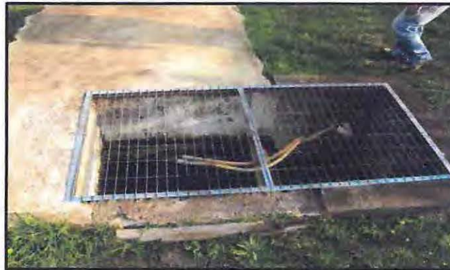
Figura 6.9- Cámara de carga e inyección de coagulantes Fuente: Proyecto, Diseño mejoramiento sistema de producción de agua potable de Collipulli, elaborado por S&E consultores.
