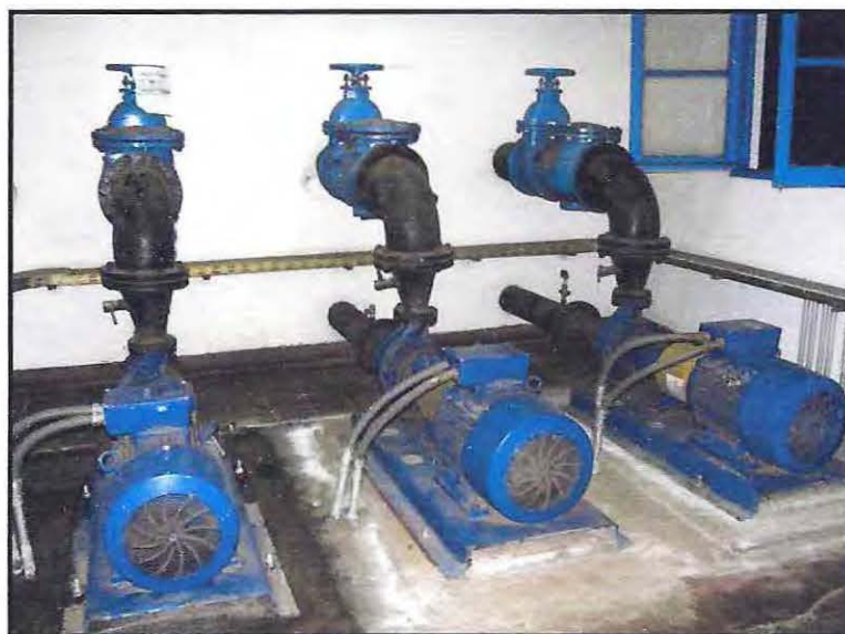
Figura 6.6- Equipos de bombeo PEAP planta de tratamiento Fuente: Proyecto, Diseño mejoramiento sistema de producción de agua potable de Collipulli, elaborado por S&E consultores.
