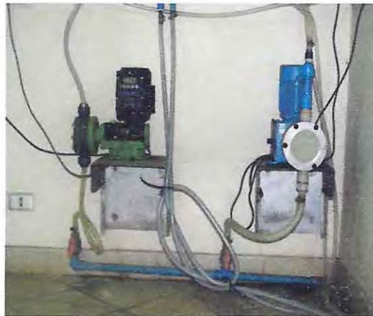
Figura 2.5: Equipos de fluoruración, PTAP Collipulli.
