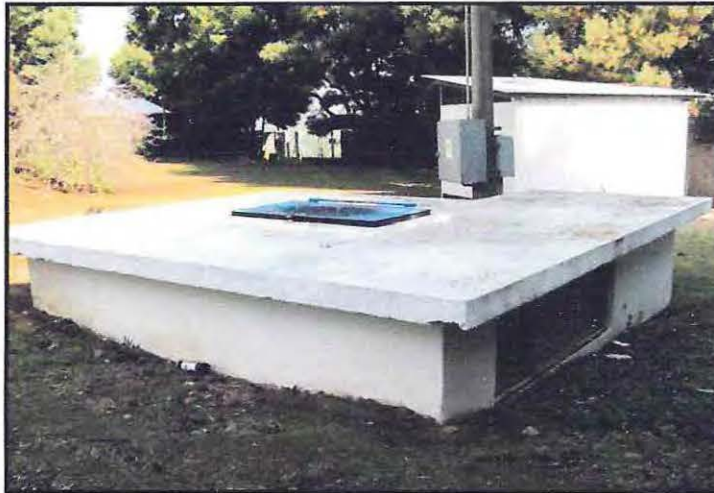
Figura 6.7- Caseta de bombeo PEAP recinto estanques Santa Lucia Fuente: Proyecto, Diseño mejoramiento sistema de producción de agua potable de Collipulli, elaborado por S&E consultores.
