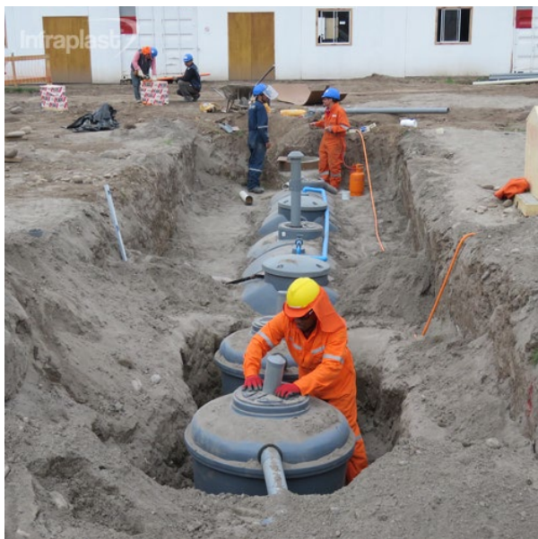
Ilustración 2.2.2.4.1: Instalación de reactor biológico.
