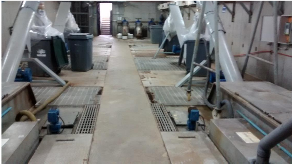
Módulos de Tratamiento PTAS Higerillas. Captura fotográfica Enero 2016
