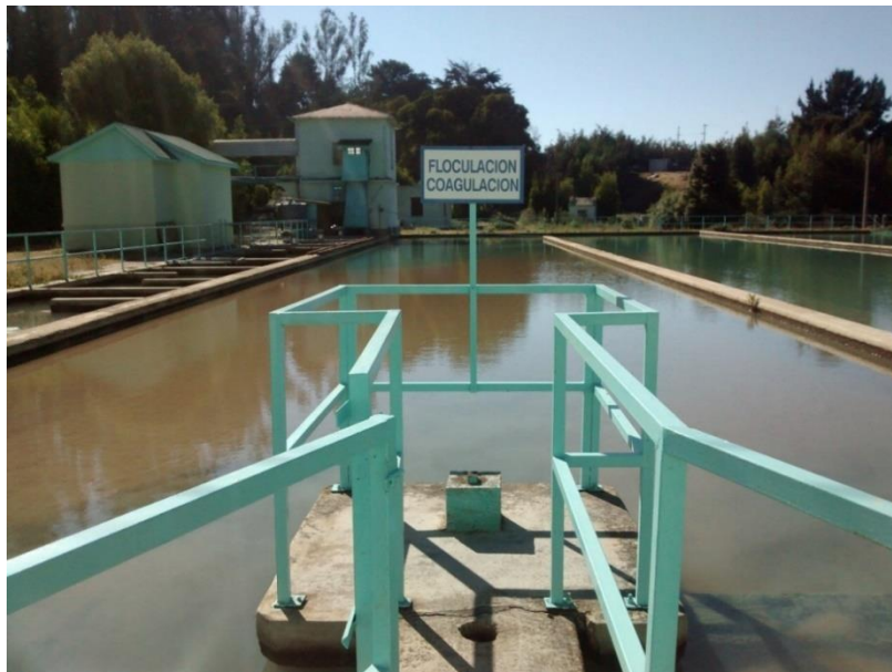
Estanque de Decantación PPAP Peñuelas. Captura Fotográfica Junio 2016
