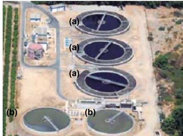
Figura 2.6 - PTAS El Molino, Quillota (Imagen entregada por Sub Gerencia de Mantenimiento)
