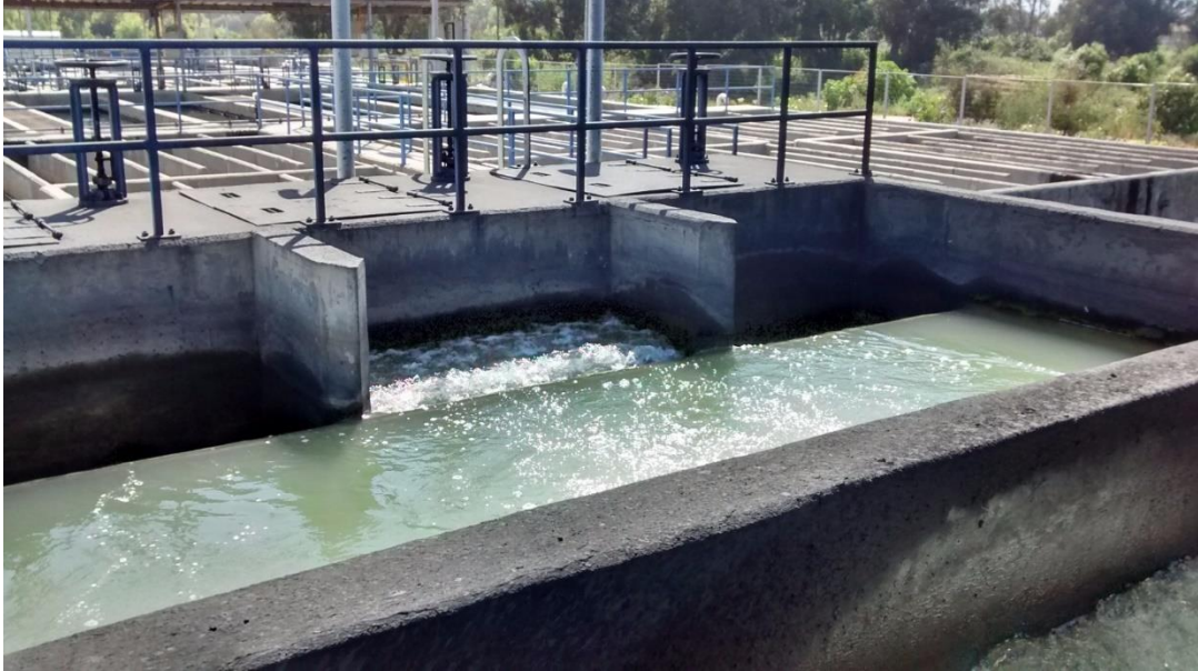
Cámara Repartidora 2 PPAP Concón. Captura fotográfica Octubre 2016
