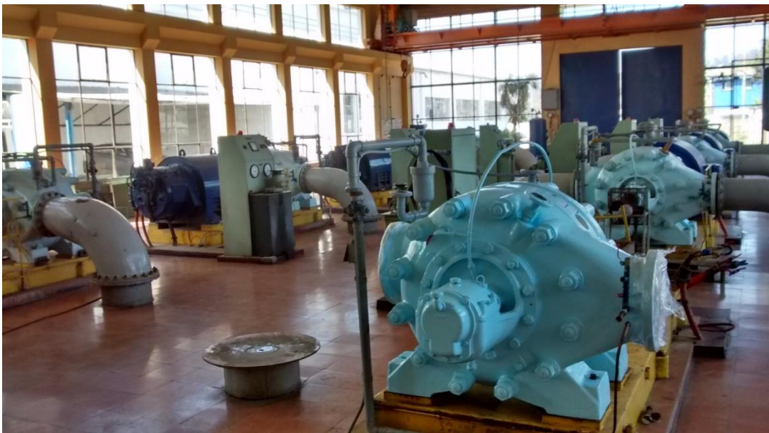
Sala de Alta PPAP Concón. Captura fotográfica Octubre 2016
