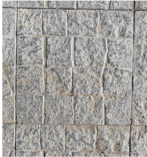
Figura 5.6: Baldosas de escoria en la plaza Villa el Sol, Catemu
