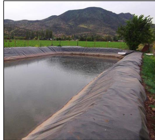
Figura 5.13: Geomembrana instalada en tranque acumulador. Fuente:
