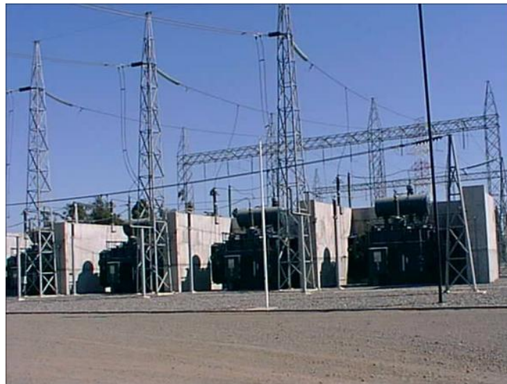
Figura 4.5 - Banco Transformadores de poder Subestación Los Almagros 220/110 kV
