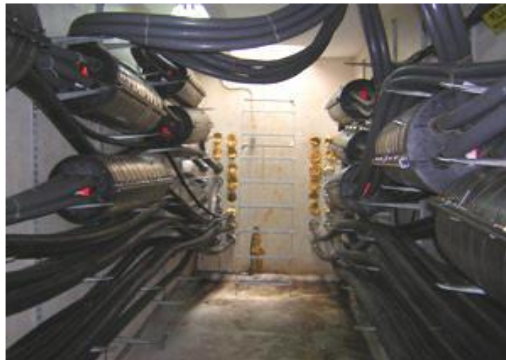
Figura 4.11 - Cámara Cables subterráneos en Network Subestación San Cristóbal
