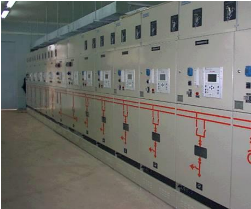
Figura 4.7 - Celdas de Media tensión 12 kV de Subestación Los Conscriptos
