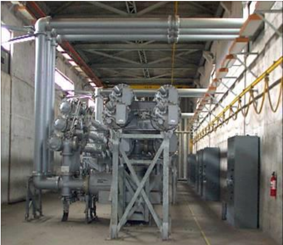
Figura 4.6 - Equipo encapsulada en SF6 de Subestación Los Conscriptos 110/12 kV
