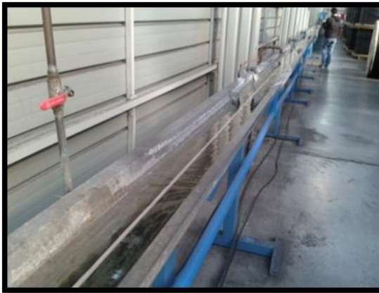
Figura 1.21: Canaleta de enfriamiento.
