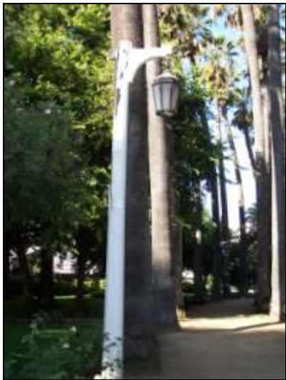
Imagen 3.139: Luminaria, Farol de una columna. Fuente: Elaboración Propia, año 2010.
