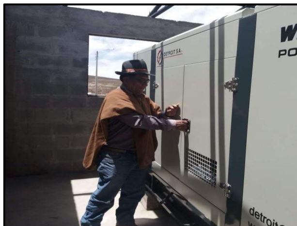
Figura n°17. Presidente de la Comunidad junto al Generador (Fuente: Propia).
