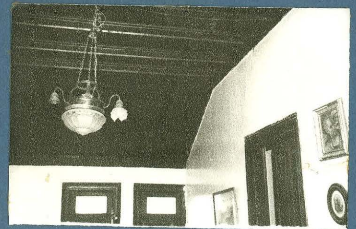
FOTO 15: Quiebra techo en la zona de escaleras entre 1er y 2do nivel.
