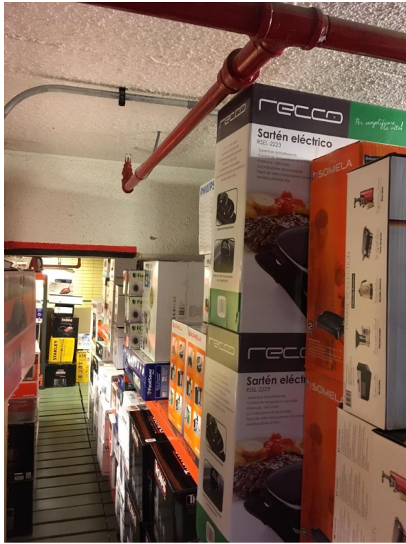
Figura 4.16: Productos a la altura de las cañerías de “splinters”.
