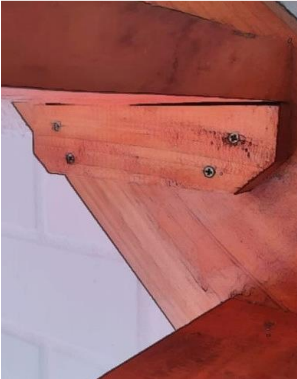
Figura 7. 3 - Fotografía - Caso de estudio, apoyos de peldaño: LOS NARANJOS III: Peña Blanca (FUENTE: PROPIA, 2023)
