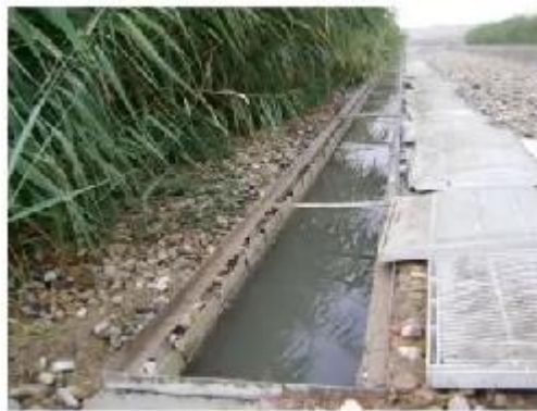
Figura 5.5: Canal de distribución de caudal PTAS Verdú
