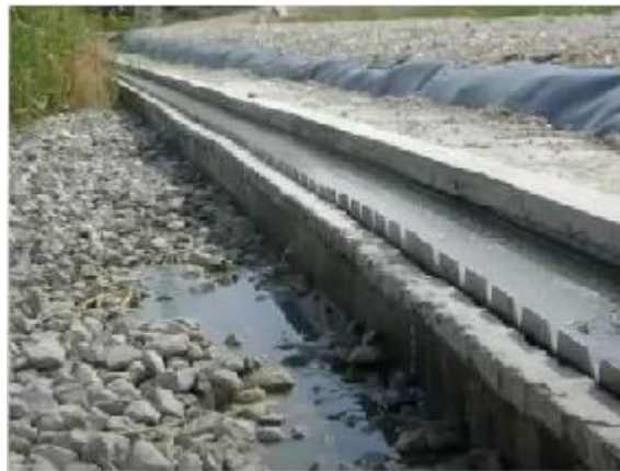
Figura 5.6: Sistema de Dientes de filtrado de la PTAS de Verdú
