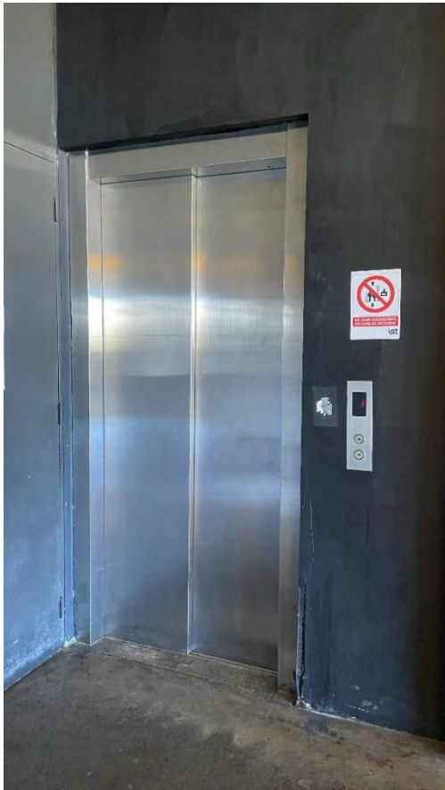
Figura N°3.136: Ascensor. Fuente: Elaboración propia.
