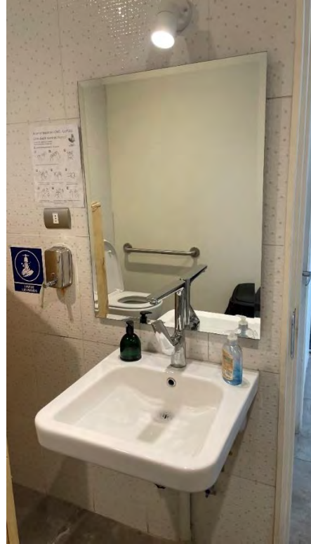
Figura N°3.161: Lavamanos. Fuente: Elaboración propia.
