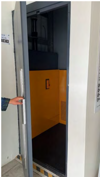
Figura N°3.154: Ascensor. Fuente: Elaboración propia.
