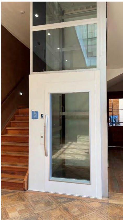
Figura N°3.130: Ascensor. Fuente: Elaboración propia.
