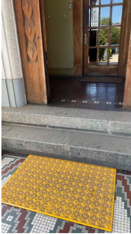
Figura N°3.104: Alerta escalera. Fuente: Elaboración propia.
