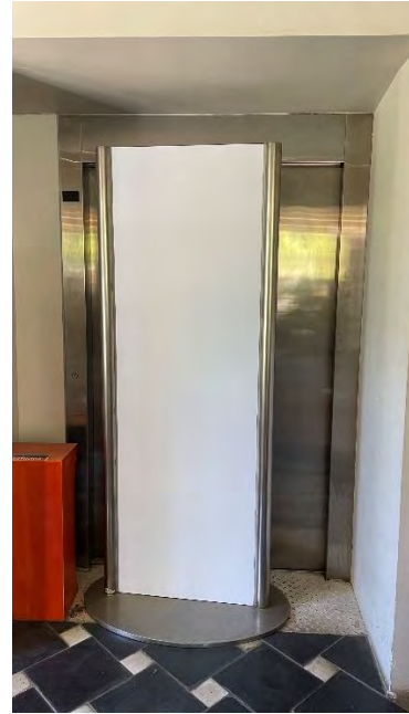
Figura N°3.7: Ascensor fuera de servicio. Fuente: Elaboración propia.
