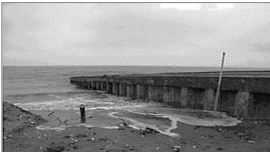
Figura 9 . Muelle Llico 1 mayo 2010 cubierto 1/3 de su longitud por el mar
