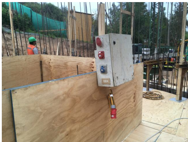
Imagen 5.19: Tablero Eléctrico de Sistema Moldaje Deslizante
