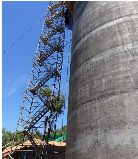
Imagen 5.2: Andamio de servicio junto a la plataforma de acceso
