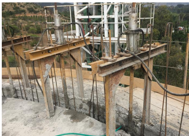
Imagen 5.17- Gatos Hidráulicos unidos por mangueras de alta presión
