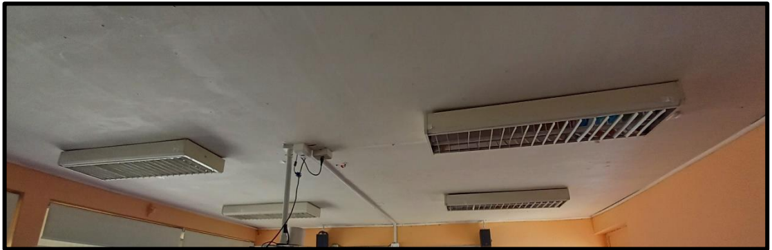
Figura 4.55: Luminarias Salas de Clases
