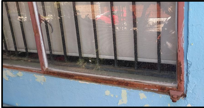
Figura 1.1: Ventanas metálicas pabellón “b” del establecimiento educacional
