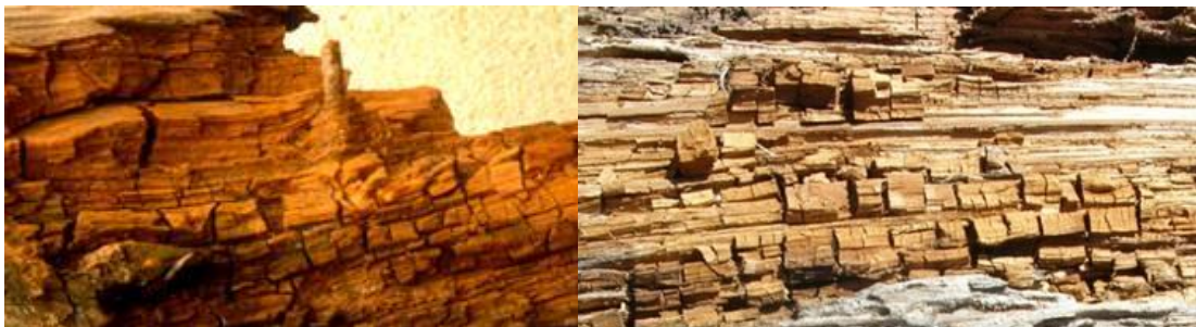
Figura 3. 5 Madera atacada por hongos de pudrición parda
