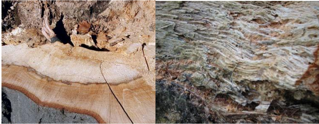
Figura 3. 4 Madera atacada por hongos de pudrición blanca
