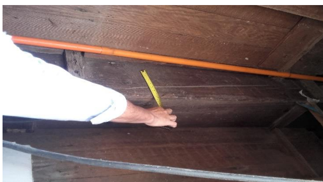
Figura 6. 1Grieta Pilar de la Torre Fuente: Elaboración propia
