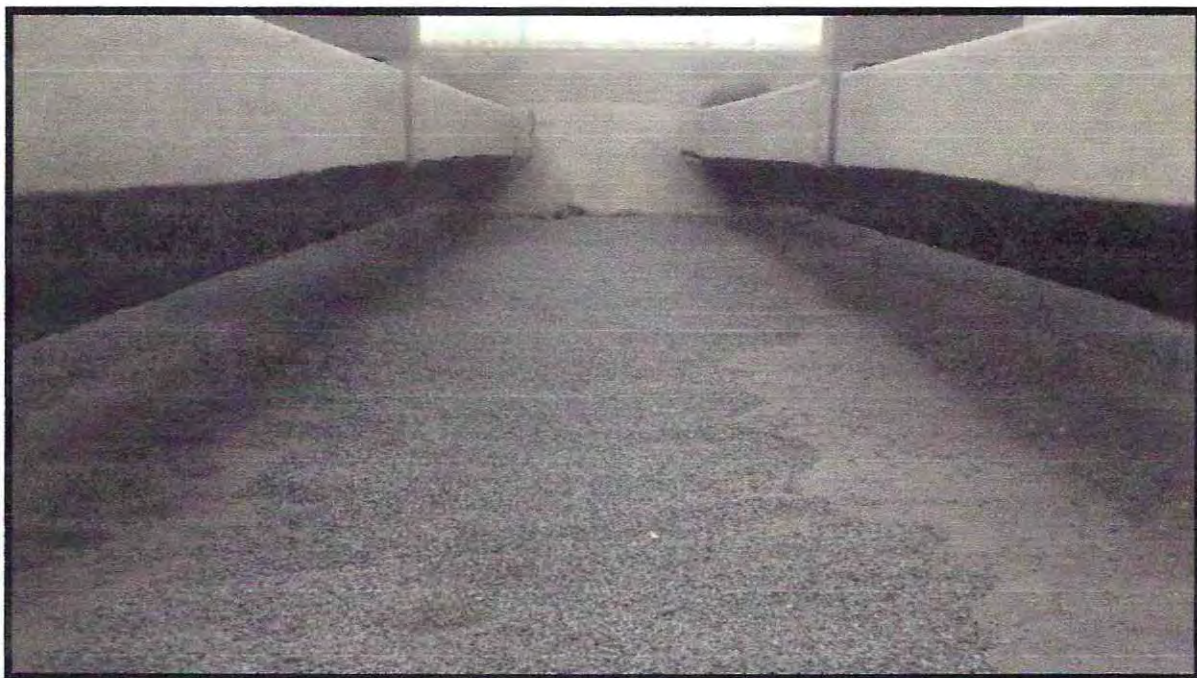
Figura- 4.2 Superficie del lecho filtrante. Ref: Planta de Concón
