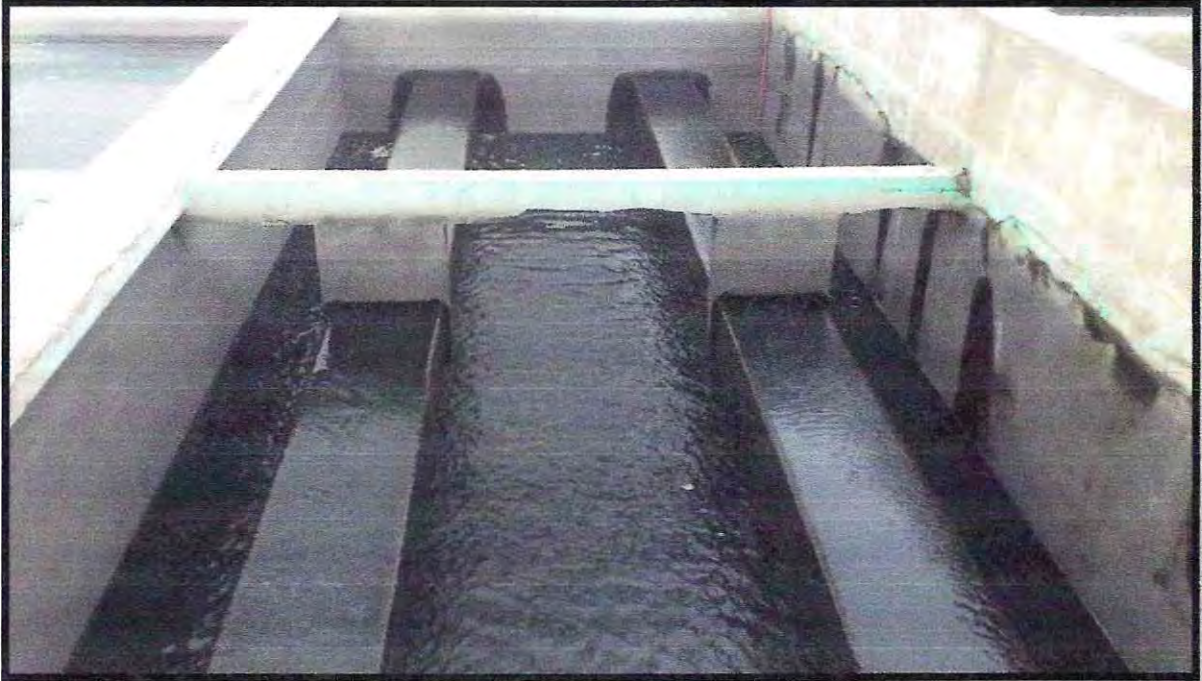
Figura- 4.4 Llenado del filtro utilizado Ref: Planta de Concón
