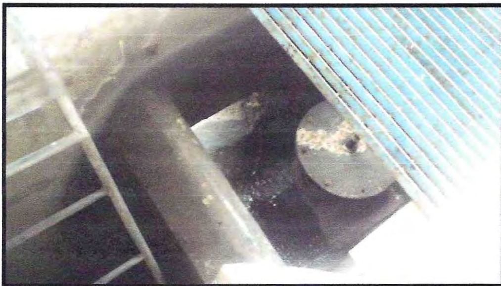
Figura 4.3- Afluente del filtro utilizado flotador desconectado. Ref: Planta de Concón
