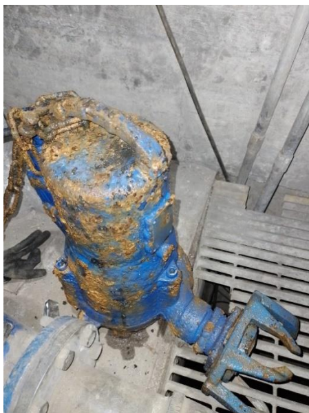
Figura 5.7 Bomba de agua luego de ser extraída de las aguas subterráneas depositadas en una de las Sentinas del metro EFE Valparaíso.
