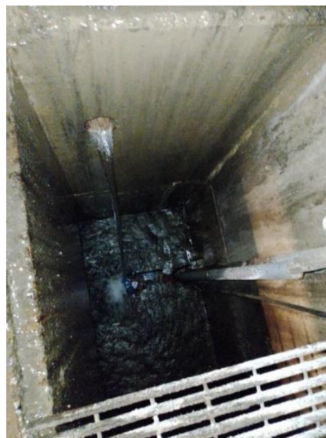
Figura 5.6 Vista desde arriba del arribo de estas aguas subterráneas hacia las Sentinas del metro EFE Valparaíso.
