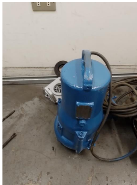
Figura 5.8 Bomba de agua nueva para ser localizada dentro de una de las Sentinas del metro EFE Valparaíso.
