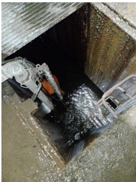
Figura 5.5 Profundidad de una Sentina de aproximadamente tres metros.
