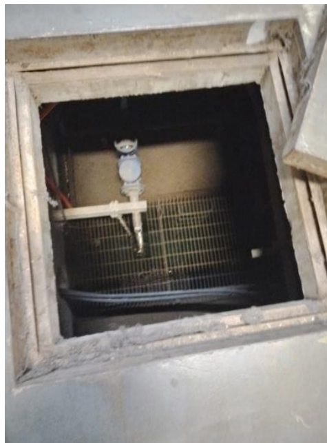
Figura 5.4 Entrada a una de las Sentinas del metro EFE Valparaíso con una medida de 2x2 metros.
