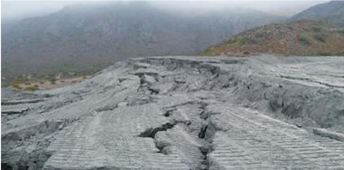
Figura 2.5 -Deformaciones por tensiones de corte sísmico en muro de un tranque de relave, resultado del terremoto del 27 de febrero del 2010, Región del Maule. Chile. [39]
