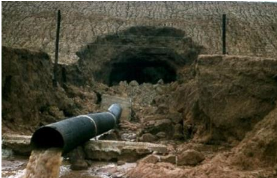
Figura 2.7 - Falla en talud debido a erosión interna debido a fuga en tubería. [40]
