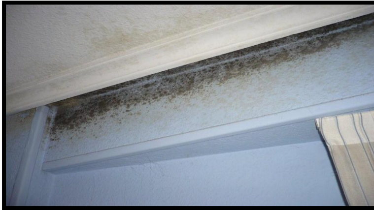
Fig. 2.13 Aparición de hongos y mohos en una pared de una vivienda.
