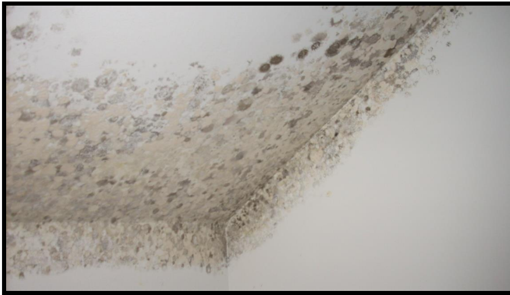
Fig. 2.7 Humedad por condensación en pared de un baño.
