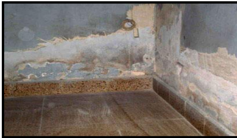
Fig. 2.14 paredes de un baño con decoloraciones y mohos.
