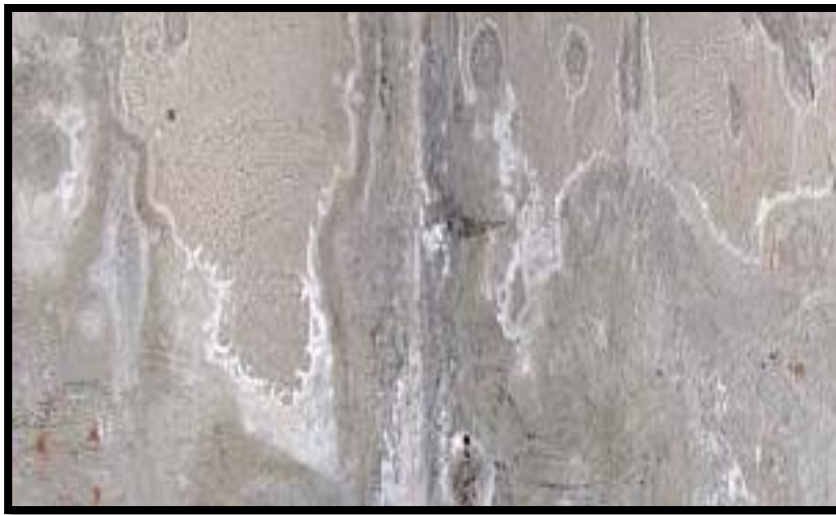
Fig. 2.12 eflorescencia en muros interiores de una vivienda.
