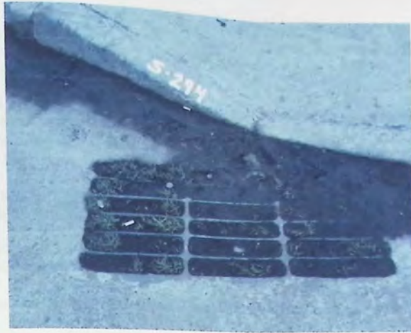
Figura 5.13 – Sumidero SERVIU S2 embancado
