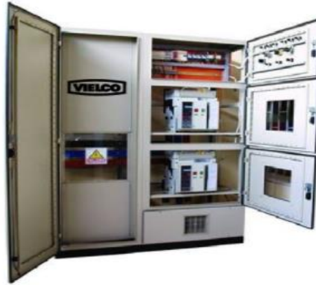
Figura 5 8: Tablero de transferencia automática.
