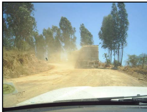
Figura 12: Deterioro de caminos rurales por tránsito vehicular
