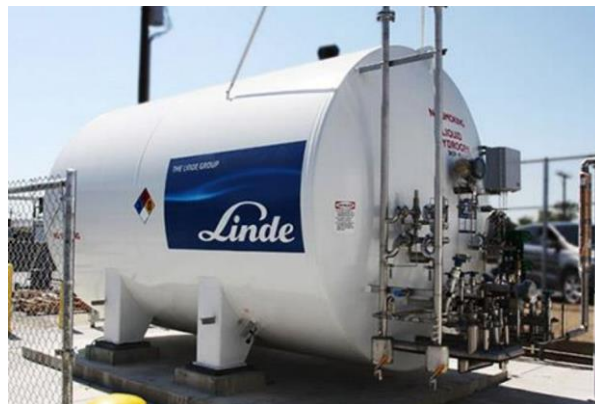
Figura 1.26: Tanque de hidrógeno líquido (GIZ, 2021)
