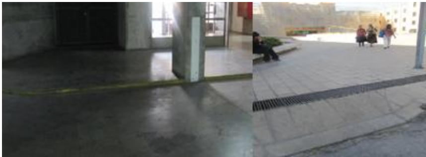
Figura 4. 6 Zócalos que no facilitan acceso
