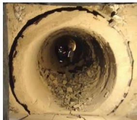
Figura 3.3 - Derrumbe de ladrillos en interior horno de clinker
