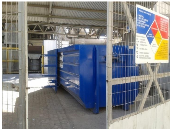
Figura 1.5- Batea con combustible alternativo solido Fuente: Visita a planta Melón La Calera
