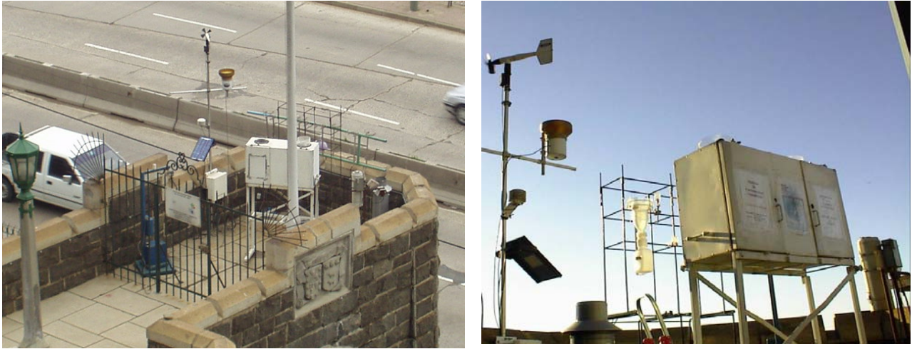
Fig. 5.1B - Estación Torreón de la UTFSM (izq.: vista aérea, der.: gabinete de protección de CPDT)
