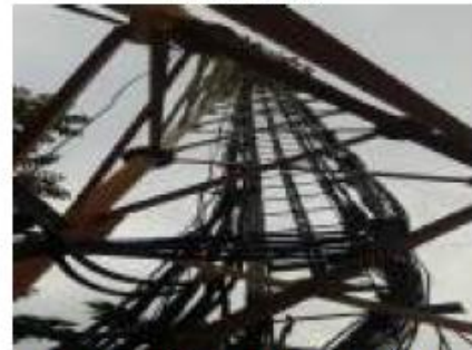
torre y sistema de seguridad
