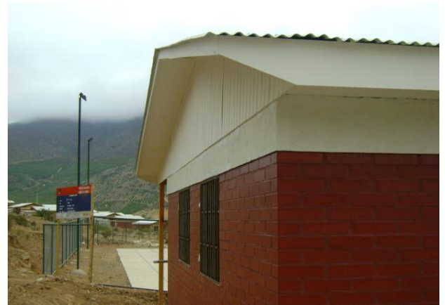
Construcción de Sede Social y Multicancha, sector La Chimba al fondo viviendas sociales.
