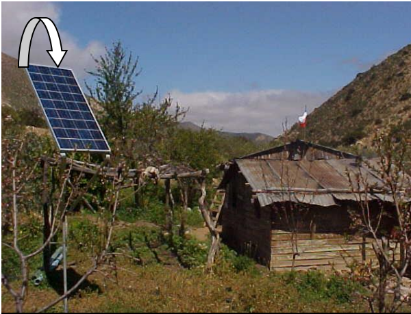
Suministro Electricidad a través de paneles solares
