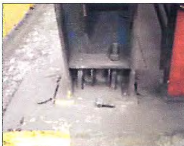
Figura 1.2: Fluencia y rotura en pernos de anclaje.
