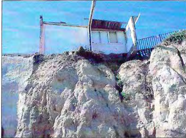
Figura 51: Casa dañada por motivos de la erosión del farellón (vista centralizada). (Fuente: Elaboración Propia).
