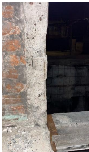
Pilar segundo piso dañado
