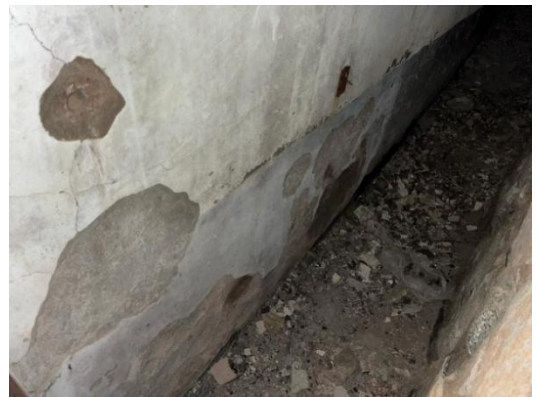
Spalling de capa revestimiento muro posterior vivienda
