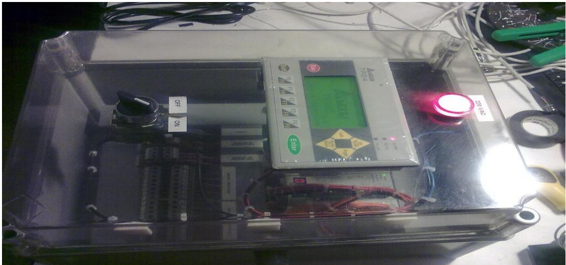
Fig. 1. Panel principal de Control Automático de alimentación. Utilización de PLC y MI.
