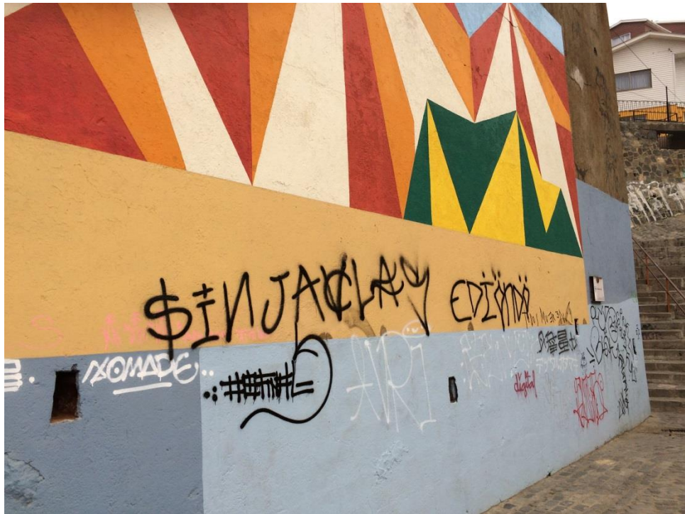
Ilustración 184, Daños sobre Mural 12 de Ramón Vergara Grez. 384
