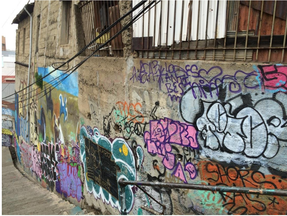
Ilustración 183, Deteriorado Mural 2 de Gracia Barrios. 383
