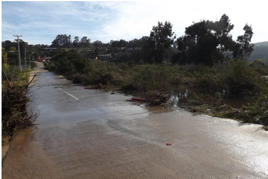
Figura 41: Desborde del cuerpo de agua en puente de acceso.
