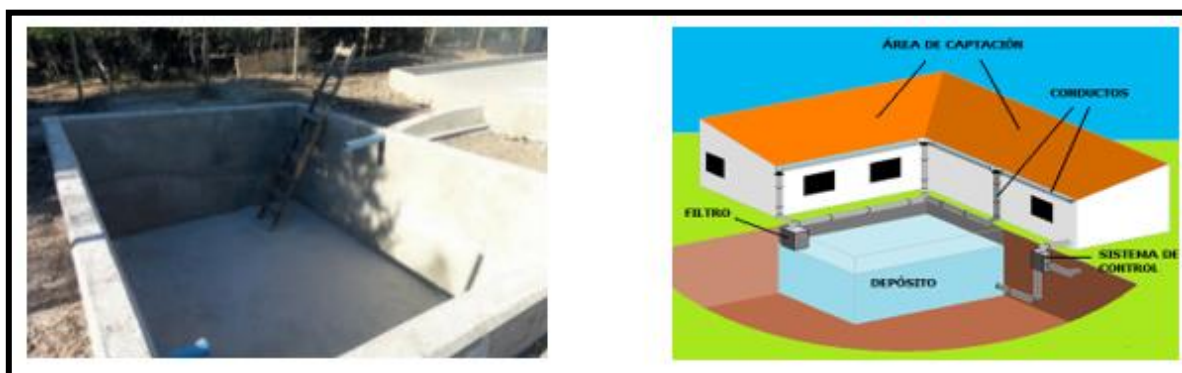
FIGURA N° 58: SISTEMAS DE ACUMULACIÓN CON ARMADO DE HORMIGÓN. FUENTE: REDAGRICOLA, 2017.
