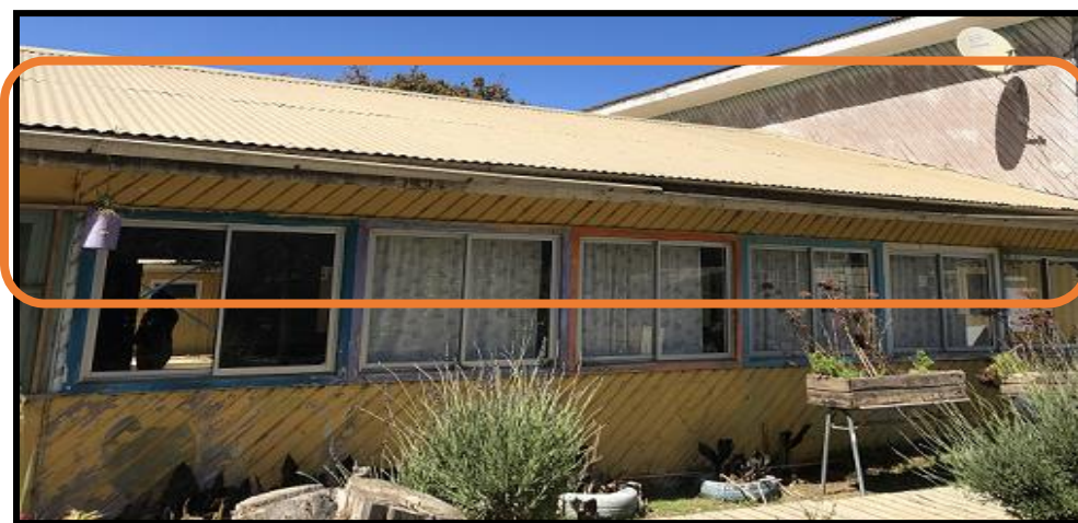
FIGURA N° 211: INCLINACIÓN DEL TECHO DE LA ESCUELA DE LAGUNA VERDE, VALPARAÍSO.
