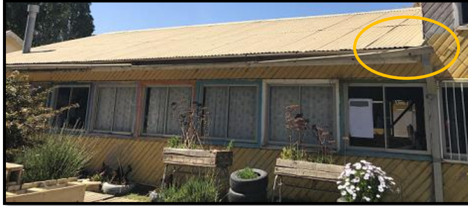
FIGURA N° 31: SISTEMA DE CANALETAS EN ESTABLECIMIENTO LAGUNA VERDE.
