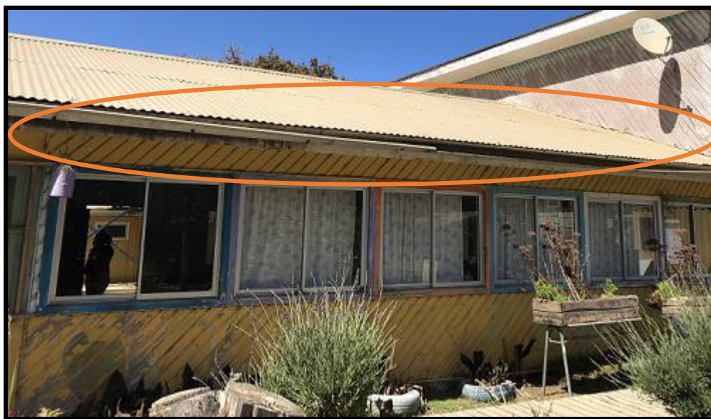
FIGURA N° 30: SISTEMA DE CANALETAS EN ESTABLECIMIENTO LAGUNA VERDE.
