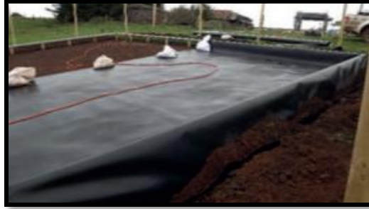
FIGURA N° 52: ZANJA DONDE SE POSICIONA LA GEOMEMBRANA. FUENTE: MANUAL DE DISEÑO Y CONSTRUCCIÓN DE SISTEMAS DE CAPTACIÓN DE AGUAS LLUVIAS EN ZONA RURALES DE CHILE, 2015.
