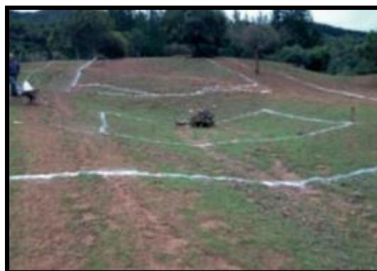
FIGURA N° 46: REPRESENTACIÓN DE TRAZADO DE TERRENO PARA INSTALACIÓN DEL SISTEMA. FUENTE: MANUAL DE DISEÑO Y CONSTRUCCIÓN DE SISTEMAS DE CAPTACIÓN DE AGUAS LLUVIAS EN ZONA RURALES DE CHILE, 2015.
