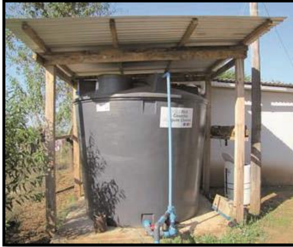
FIGURA N° 36: SISTEMA DE BOMBEO PARA EXTRACCIÓN DE AGUA. FUENTE: PORTALFRUTICOLA: CONSTRUCCIÓN SISTEMA DE CAPTACIÓN Y ACUMULACIÓN DE AGUA LLUVIA PARA RIEGO, 2017.
