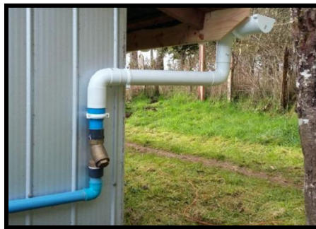
FIGURA N° 32: REPRESENTACIÓN DE SISTEMA DE CONDUCCIÓN DE AGUA CAPTADA HACIA EL ESTANQUE. FUENTE: AGROTECNIA, 2019.
