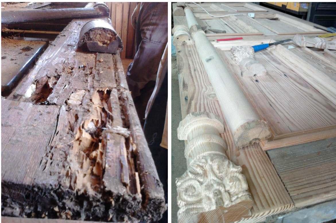
Figura 2.8: Al lado izquierdo, una de las puertas de la iglesia “La Matriz” de Valparaíso antes de su restauración, y al lado derecho, la misma puerta en una etapa avanzada de restauración.
