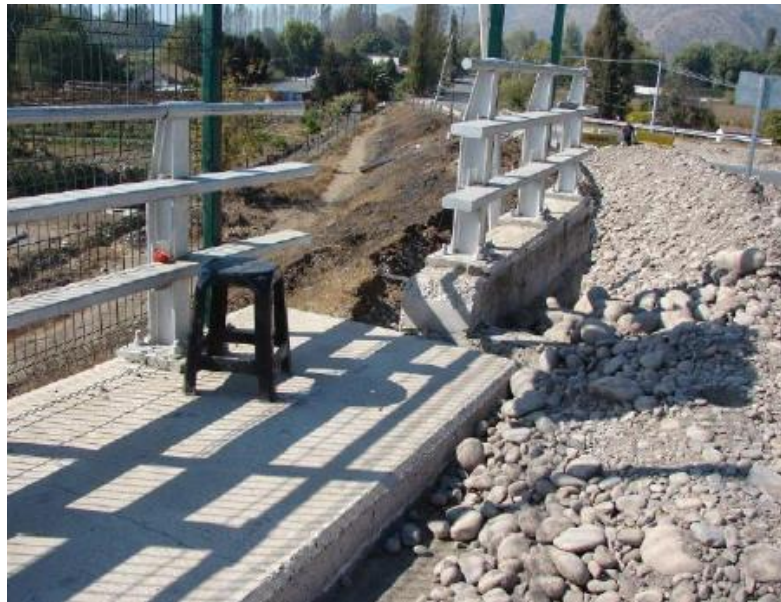
Figura 3.24: Desplazamiento relativo en extremos, Puente Chada [9].
