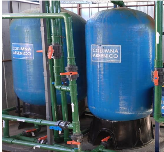
Figura 3-15: Filtros de resina implementados actualmente en la planta de tratamiento
