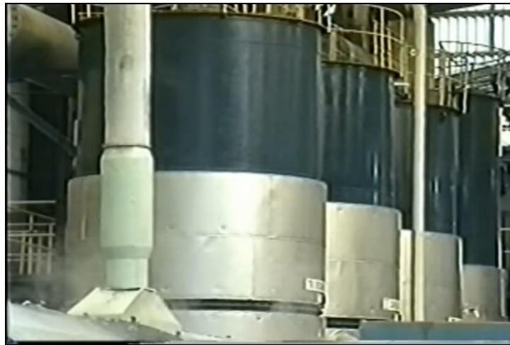
Figura 6: Estanques donde se realiza el proceso de Purificación.
