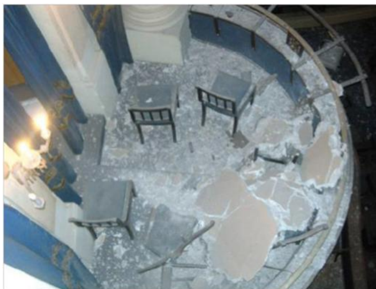
Imagen 6: Colapso de revestimiento de yesos
