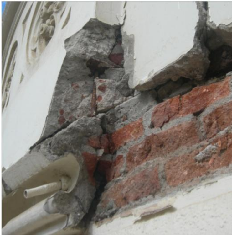
Imagen 9: Daño en muros
