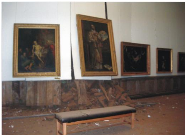
Imagen 8: Daño en muros
