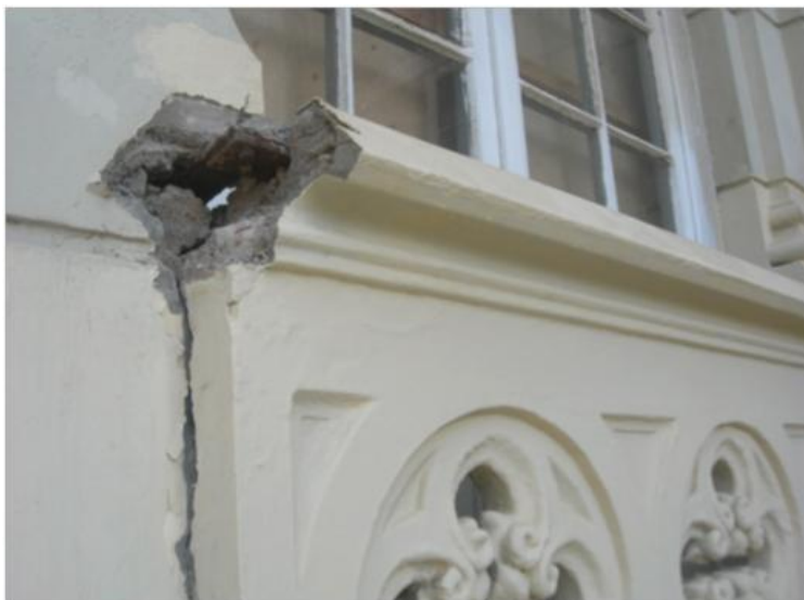
Imagen 10: Colapso de balcones
