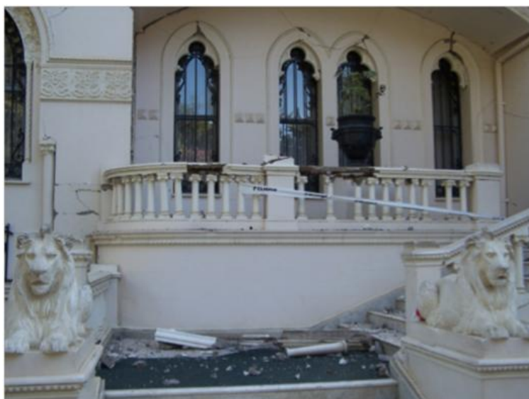
Imagen 7: Daño en balaustrada
