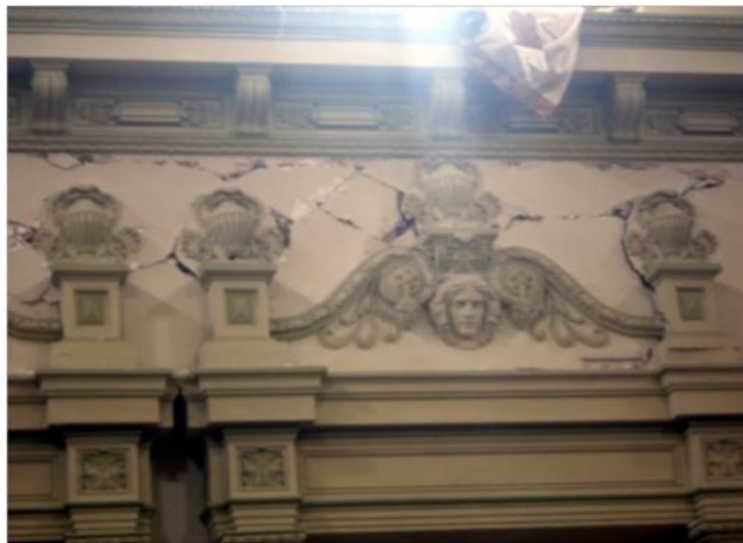
Imagen 11: Desplome de enlucidos de enlucidos
