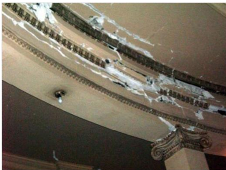
Imagen 5: Daño en enlucidos de yeso
