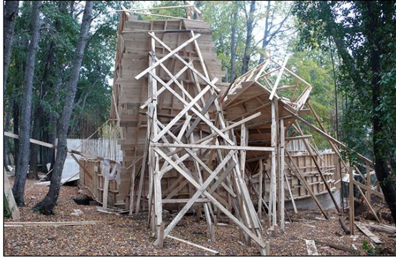
Imagen 24 Estructura provisoria y faena Casa para el poema del ángulo recto. Fuente: arquitecturag.wordpress.com
