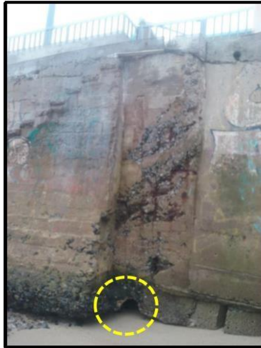
Ilustración 20: Muestra perforación inferior del muro sometido al desgaste.
