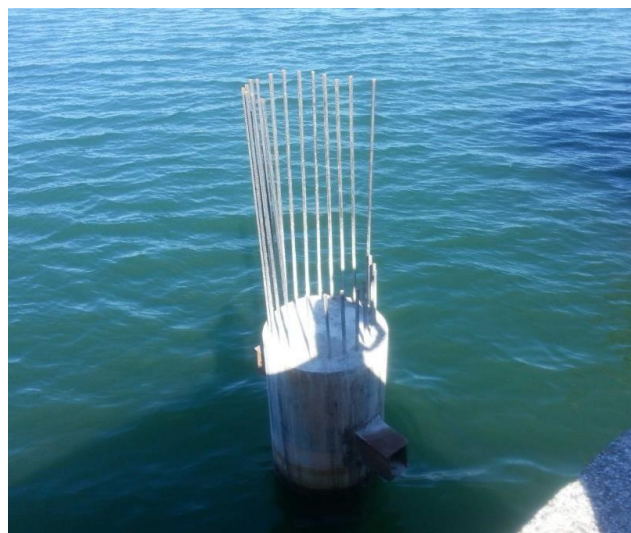
Ilustración 18: Pilote hormigonado en contacto con el agua de mar.
