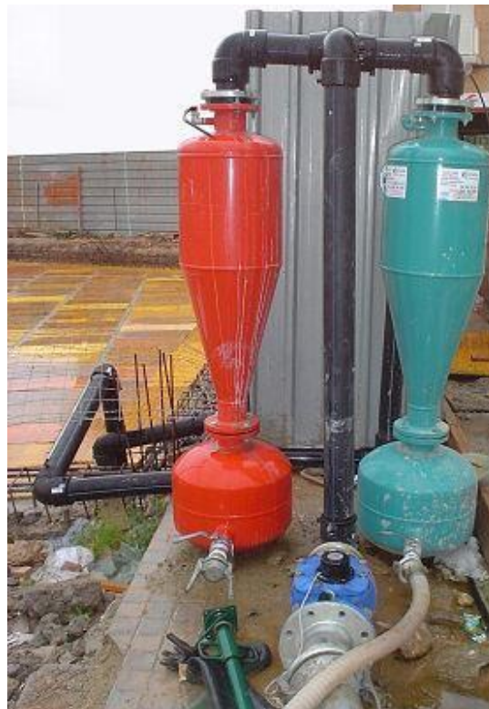
Figura 8.4 - Bomba auto aspirante para rebajamiento de napa freática. Fuente: Fuente: CYPE [31].
