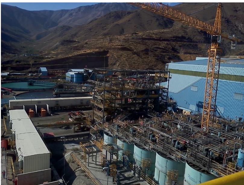
Imagen III: Planta de tratamiento. A la derecha cerchas de flotación.
