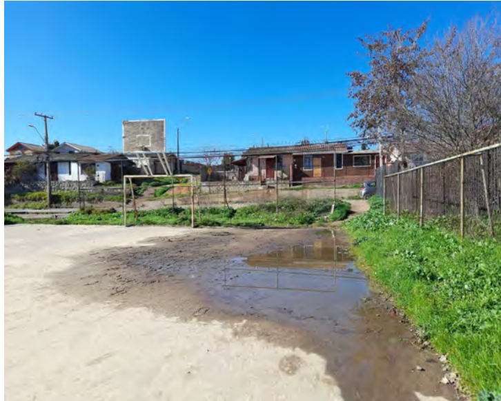
Imagen 21 Estado actual de la cancha después de un día de lluvia.
