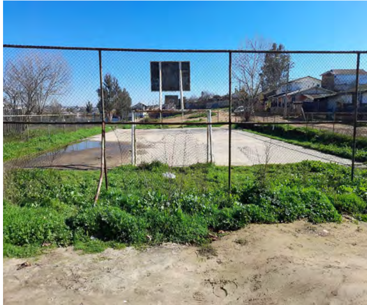
Imagen 20 Fotos del estado actual del equipamiento de la cancha.
