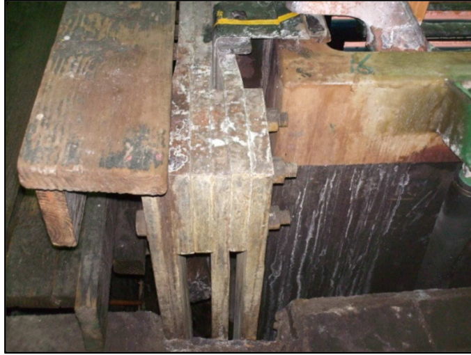
Figura 3.6 – Fotografía de barras conductoras. Fuente: (CODELCO, 2013)
