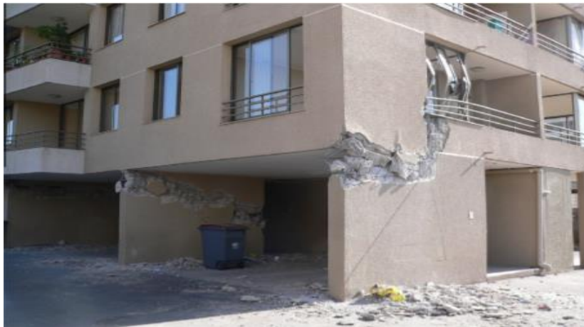
Figura 1.1 Ejemplo de edificio con daños posteriores al terremoto en Chile el año 2010.
